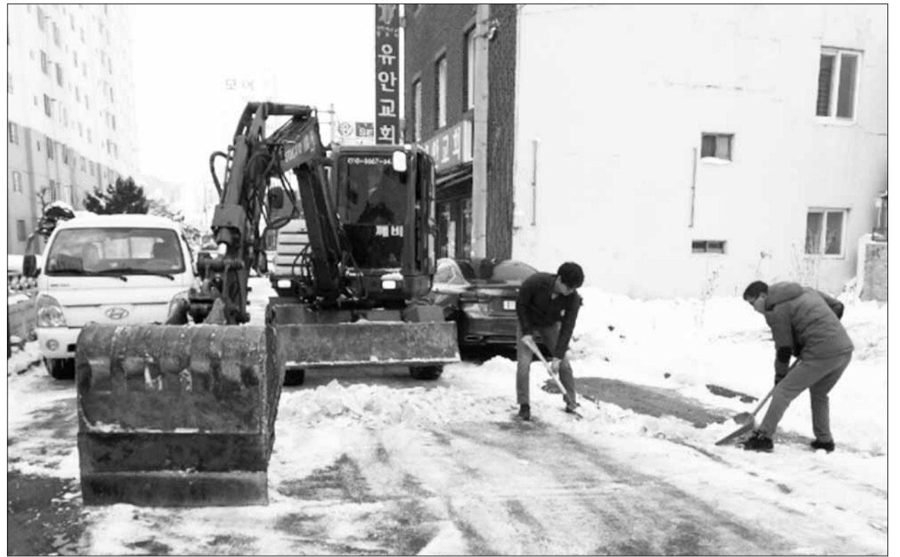
이면도로 제설작업 광주 남구청 직원들이 지난 13일 봉선2동 무등파크1차 옆 이면도로에서 얼음을 제거하고 있다. 남구는 폭설로 그늘진 이면도로에 결빙이 발생함에 따라 보행자 낙상 예방 및 차량 미끄러짐 방지를 위해 이날 포크레인 2대와 직원들을 투입, 25곳에서 얼음 제거작업을 펼쳤다. /남구청 제공
